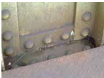
写真 - 1 支点部に発生したき裂の状態
