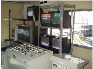
写真-4 遠隔操作装置
