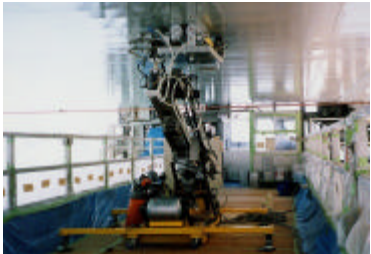
写真3 箱桁用塗装装置
