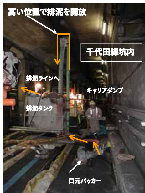
写真-2 排泥システム全景
