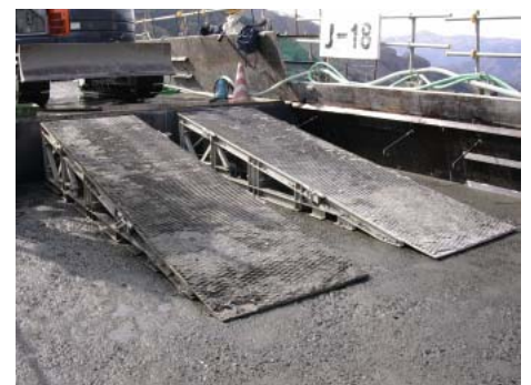
写真-4 0.75 m 鋼製スロープ
