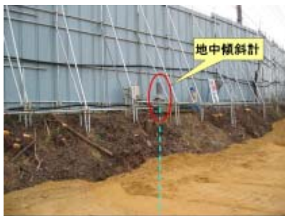
写真1. 傾斜計設置状況
