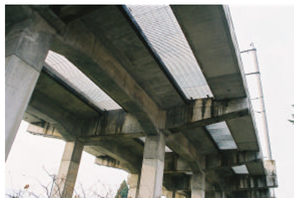
図-1 開床式高架橋 開口部
