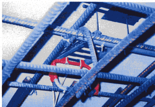
写真-2 センサー設置状況
