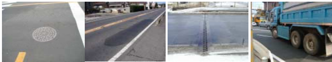
マンホール(県道 35 号) わだち掘れ(国道 118 号) 橋梁ジョイント(国道 4 号) 交差点部(国道 16 号)
