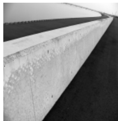
写真-1 透水シートを用いた 施工例（白色帯状痕の発生）
