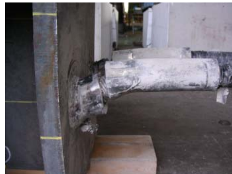
図4 接合鉄筋損傷状況写真
