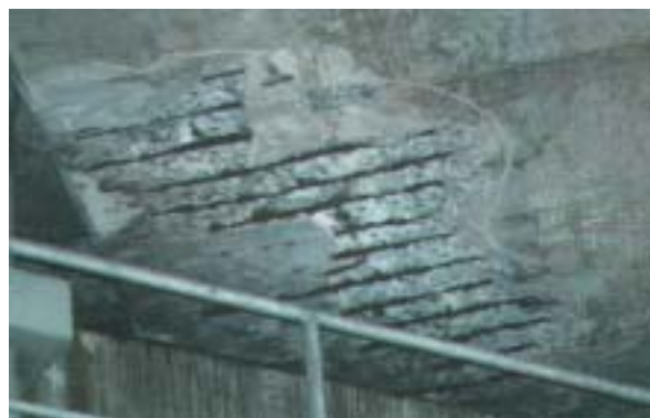
写真 1 床版端部における損傷
