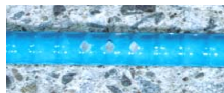
(b) E①節上の損傷
