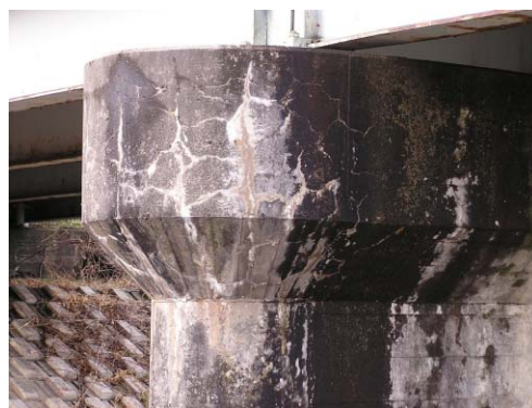
写真-2 橋脚のひび割れと析出物
