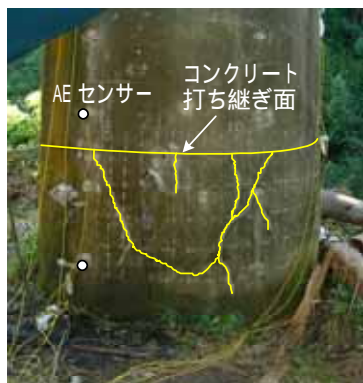
図1 P3橋脚の損傷状況
