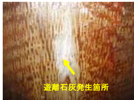
写真1 GFRP 白色箇所の状況
