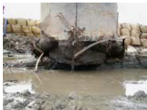
図-3 19P 上流方底面の洗掘状況
