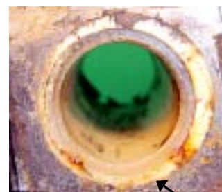
図 2 ボルト穴の状況
