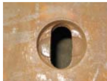
図 5 床板のざぐりの摩耗状態
