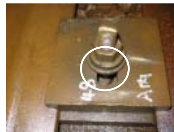
図 4 ボルトの頭の締結状態
