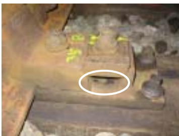
図 3 ボルトの頭の締結状態
