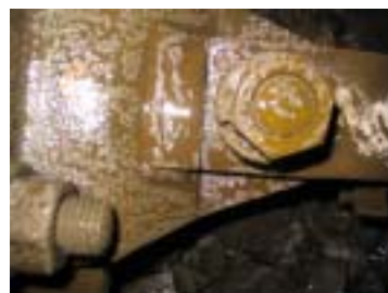
図 2 接触端面の摩耗
