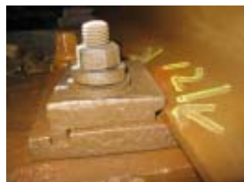
図7 座金とレール底部の隙間
