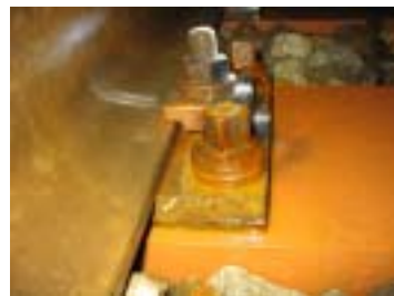
図6 座金とレール底部の隙間
