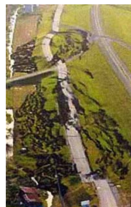
写真1 液状化によるⅢ型破壊（十勝川堤防） 4)
