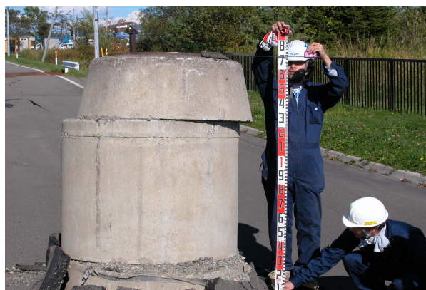
写真1 マンホールの浮上がり状況
