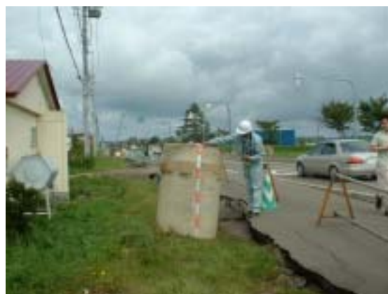
写真1 マンホールの浮き上がった状況
