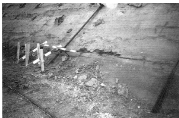
写真 - 1 切土法面亀裂発生状況
