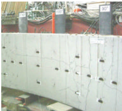
写真 - 2 覆工損傷状態
