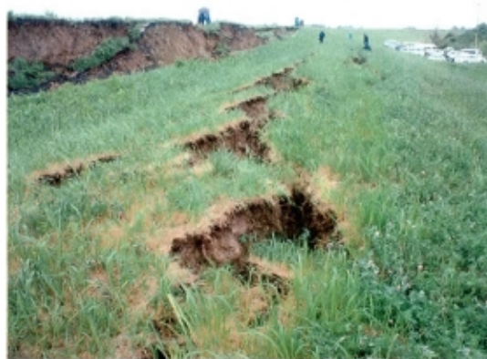
写真-1 鳴瀬川木間塚周辺における河川堤防の被害状況(右岸側)(国土交通省北上川下流工事事務所)
