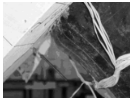
写真1 CASE1 鋼管の局部変形(図3の鋼管断面付近)
