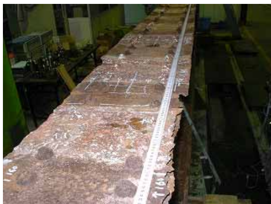
写真1 腐食状況（上フランジ上面）
