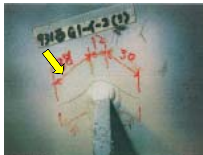
図-4 デッキプレートと垂直補剛材の き裂（溶接止端部）
