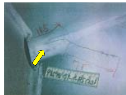
図-7 トラフリブとデッキプレートの 溶接部のき裂（横リブ交差部）
