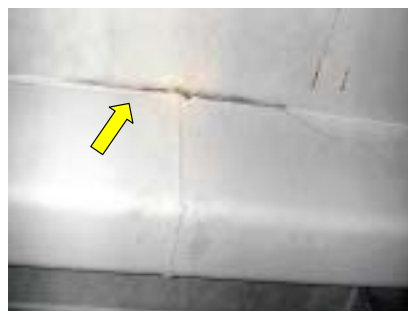
図-6 トラフリブとデッキプレートの 溶接部のき裂（縦リブ支間中央部）
