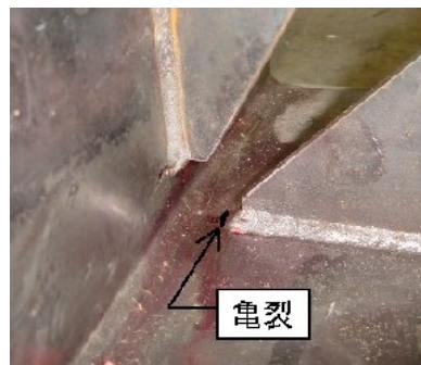
図-2 亀裂発生箇所
