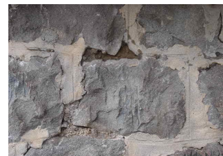
写真-2 目地材の劣化状況
