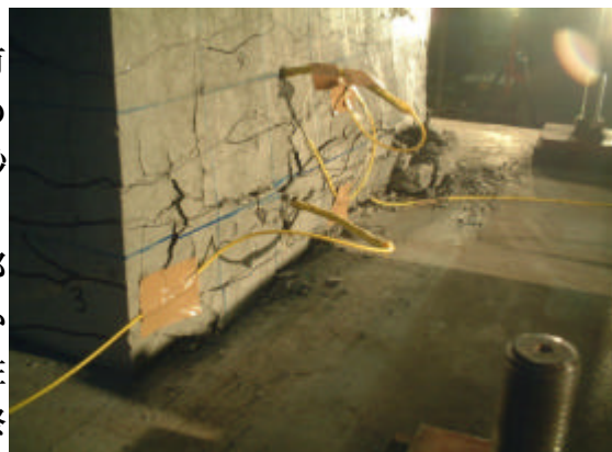
写真-2 柱基部損傷状況(80%2回目加振後)
