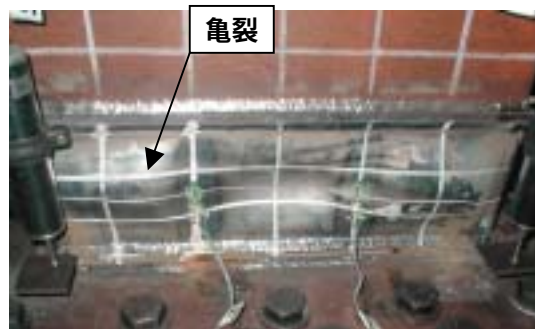
写真-1 LY-R2-7.8 の亀裂の様子
