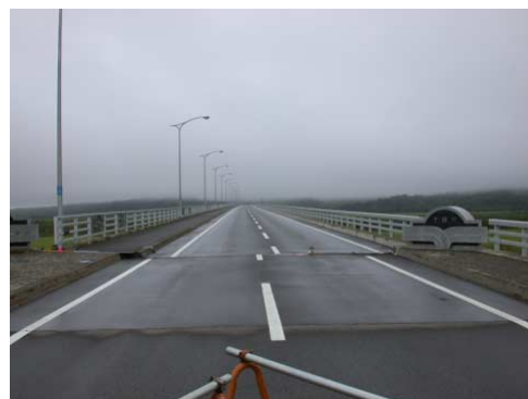
写真 - 2 十勝河口橋の横ずれ
