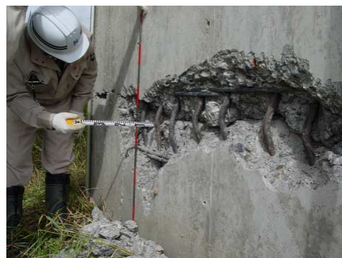
写真 - 1 千代田大橋の P13 橋脚の損傷
