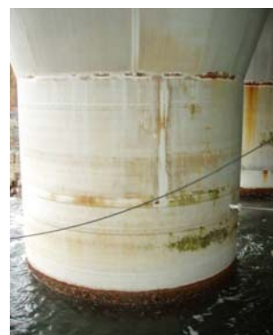
写真-2 多柱基礎腐食現況例
