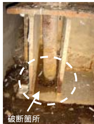
写真 - 1 アンカーボルト破断状況
