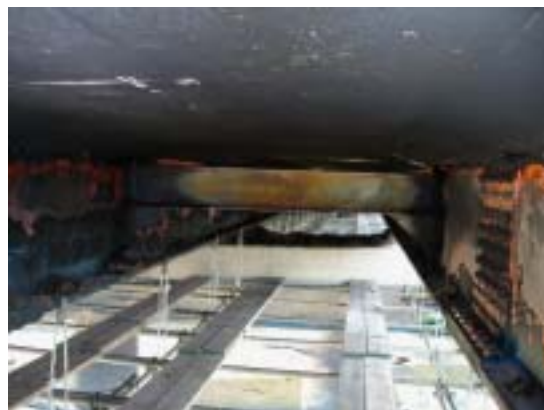
写真-1 被災状況
