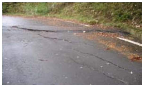
図3 光ファイバセンサ No.44 - 45 付近の道路状況
