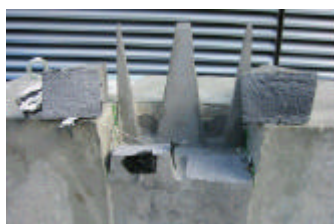
a) フェースプレート根元の破断状況
