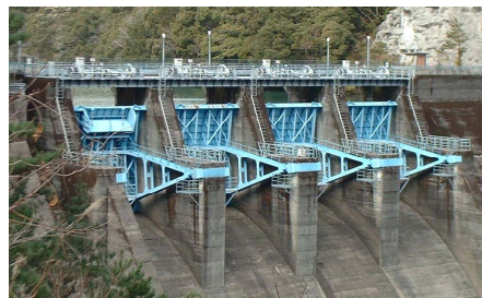
図 - 2 システムを適用した洪水叶ラジアルゲート
