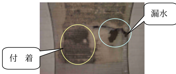
写真-3 漏水、付着物状況
