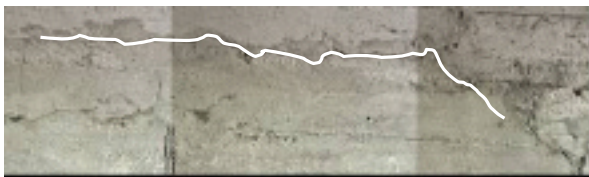
写真-1 ひび割れ状況
