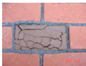
写真-5 亀甲状のひび割れ
