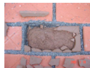
写真-6 ひび割れ内部
