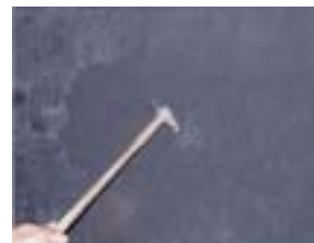
写真－1 トンネルの煤煙付着状態
