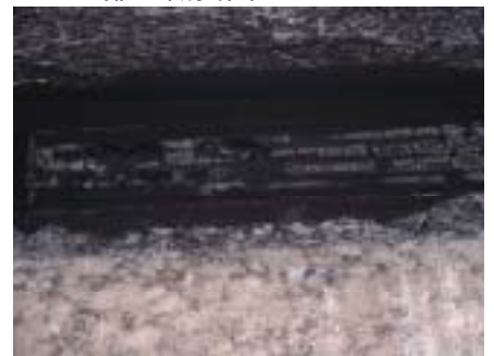
写真 - 3 P2支承の損傷状況
