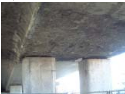
写真 - 1 損傷状況
