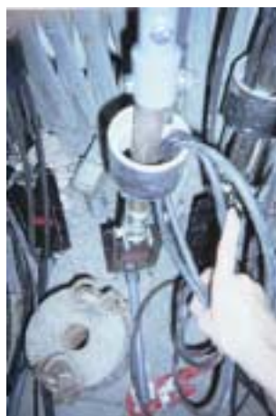
写真1 地盤ひずみ計
