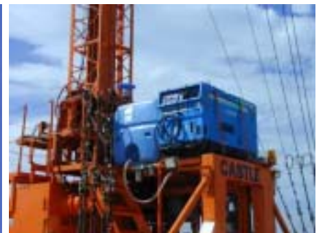
写真 - 3 空圧供給設備
