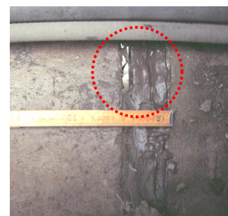
写真-3 目地部剥離状況(Type A)
