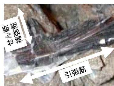
写真-1：主筋破断状況
