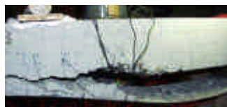
Photo 1 CFS 補強 RC 梁の破壊状況
