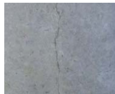
写真1 既設電柱のひび割れ
