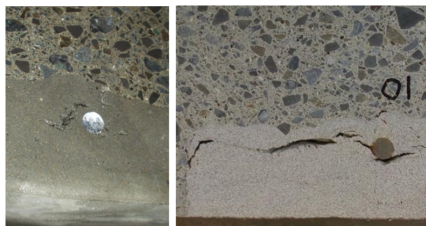
図3 鉄筋周辺部における補修材の空隙状況
